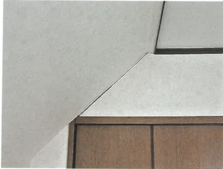
コンクリートのひび割れ ⑧
