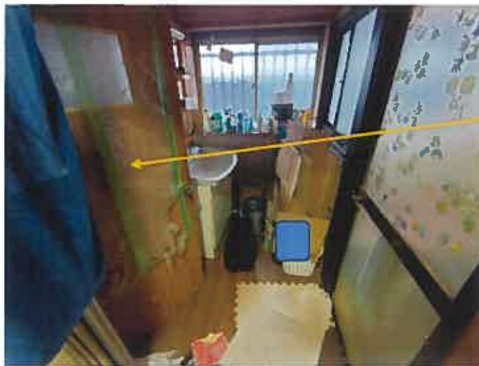
トイレドアの 開閉不具合
