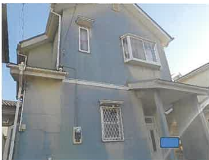
物件2近影 壁に亀裂が見られる
