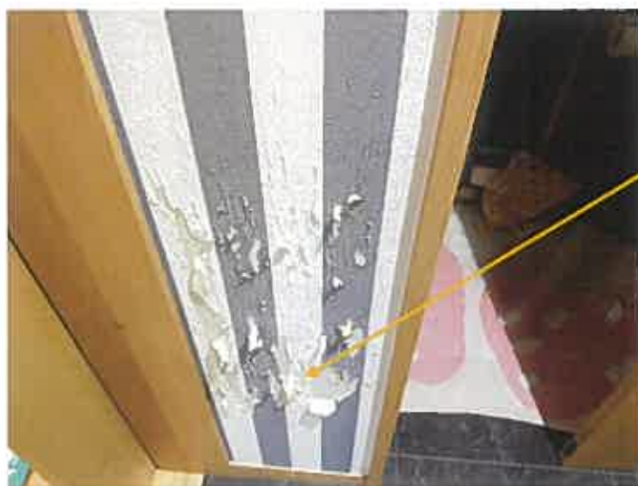
ネコによる壁クロスの の傷み
