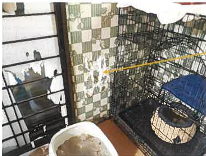
ネコによる壁クロスの の傷み
