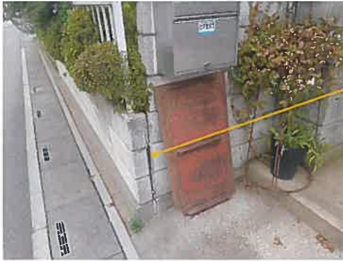
物件1南側 ブロック塀の剥離
