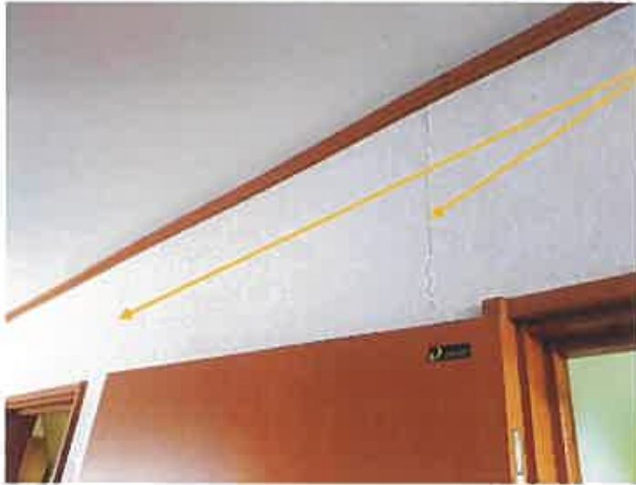
壁クロスの亀裂
