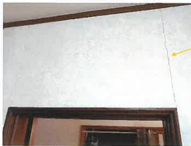
クロスの亀裂
