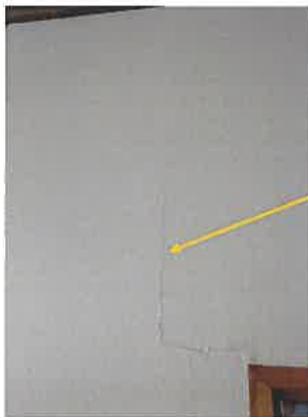
クローズの亀裂
