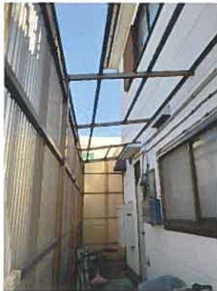
下屋の屋根部分が 台風により損壊
