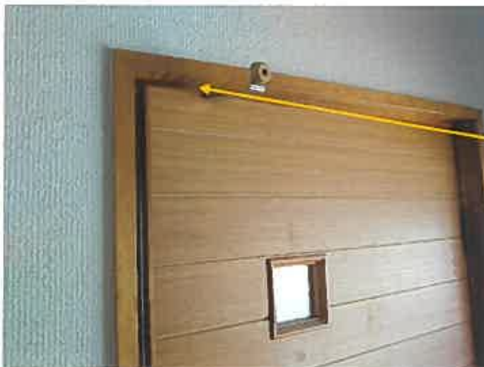
2階トイレドア の開閉が不具合
