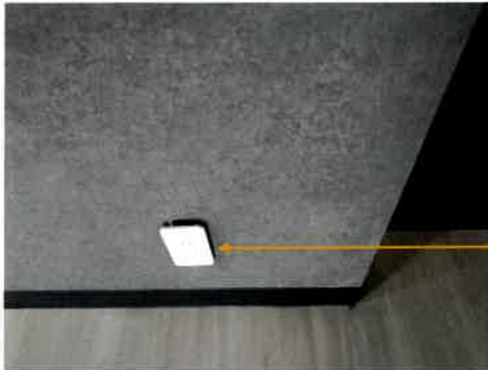
⑩ コンセント プレート カバー の不具合
