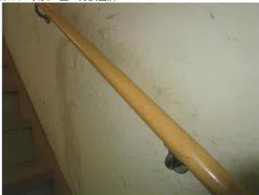
⑥ 建物内の状況 壁の汚損箇所
