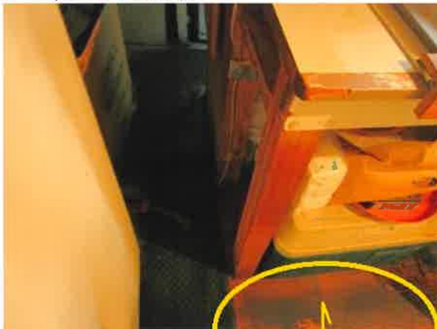
床板が柔らかく沈み込む
