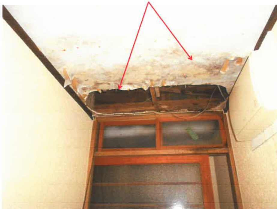
天井の損傷状況
