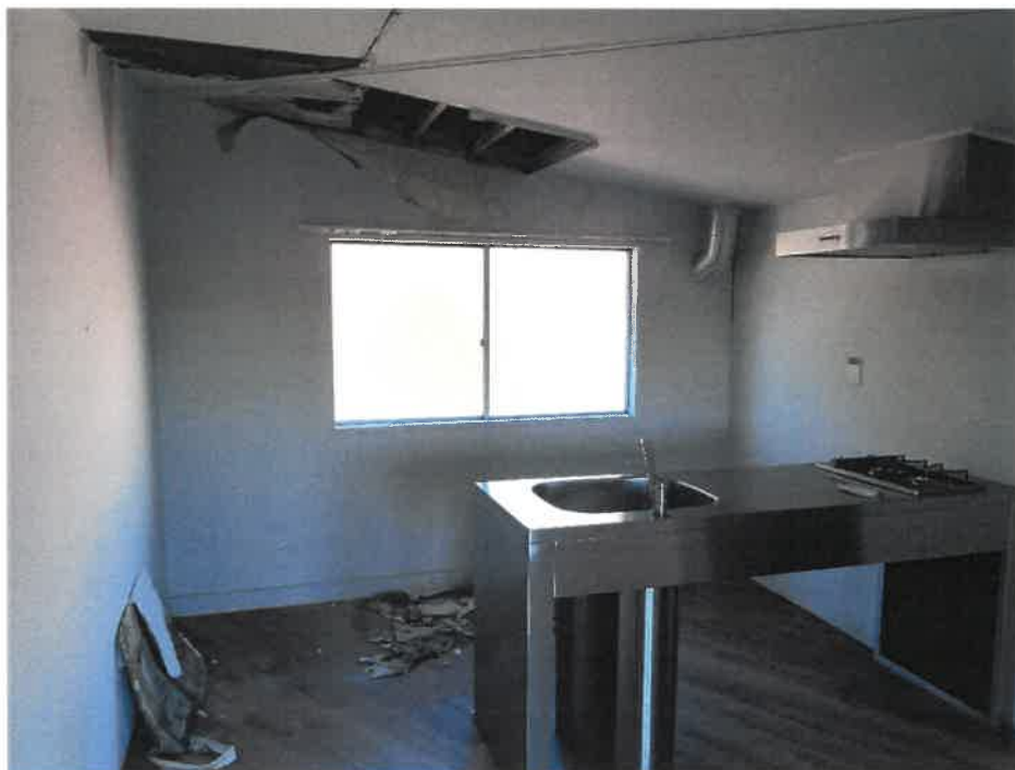
303号室キッチン天井の損傷
