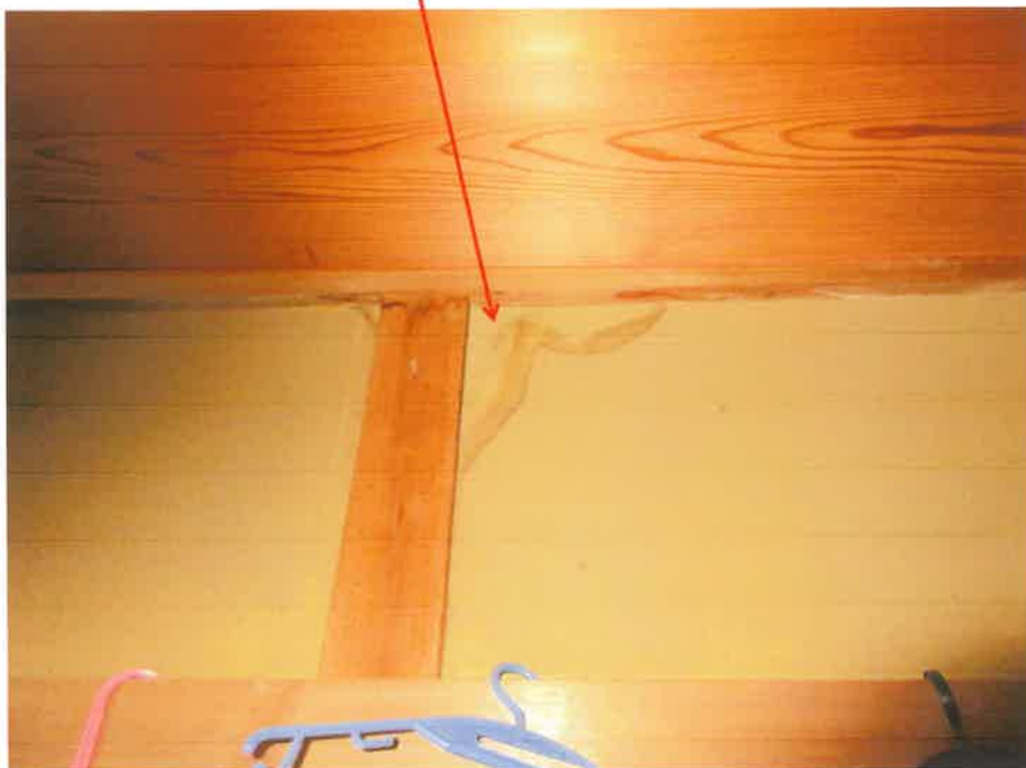
雨漏り跡の状況
