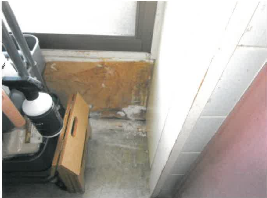
⑥ 建物内の状況 窓下壁面の損傷
