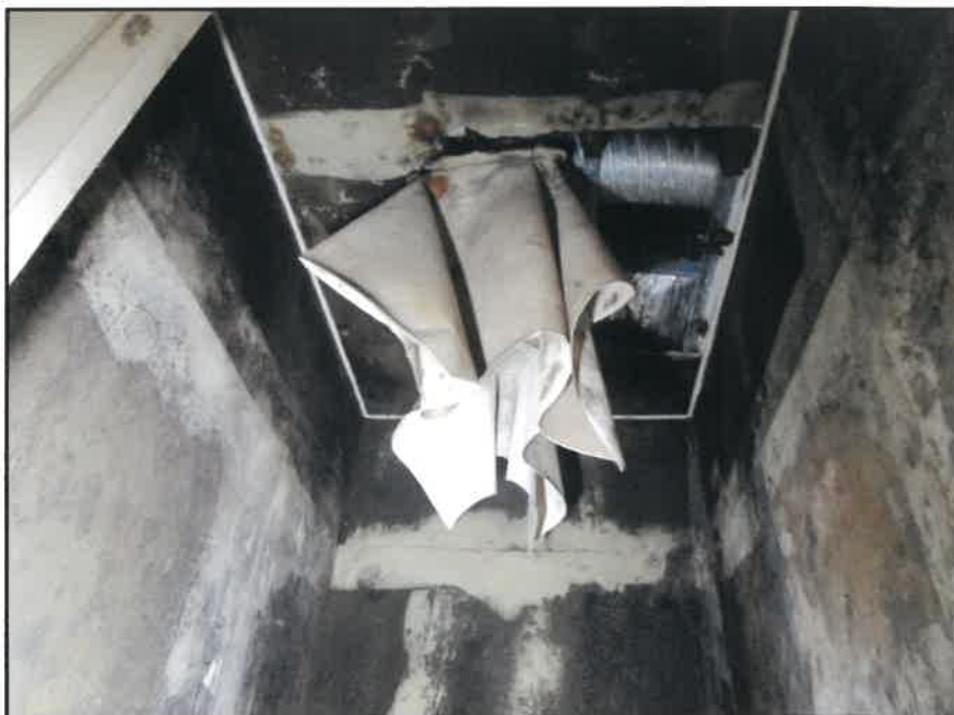
⑦ 建物内の状況ートイレ:天井
