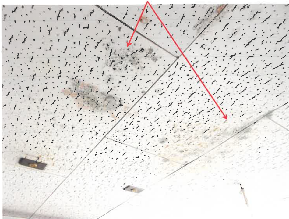
雨漏り跡の状況
