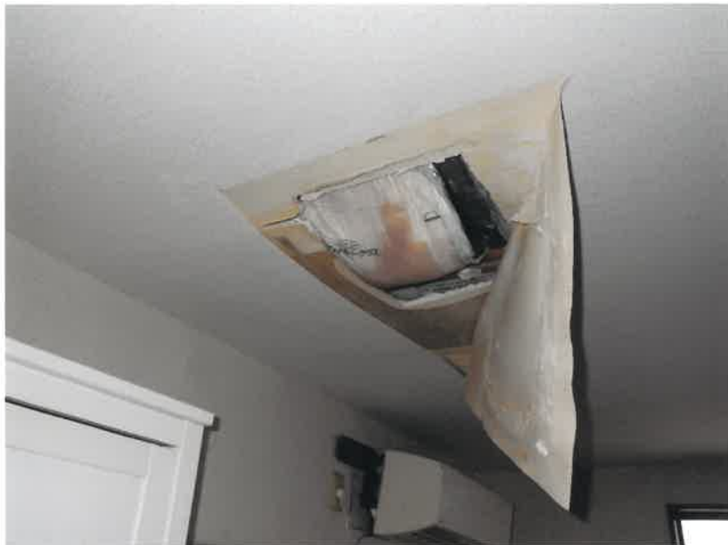
③ 1階リビングの天井損傷状況
