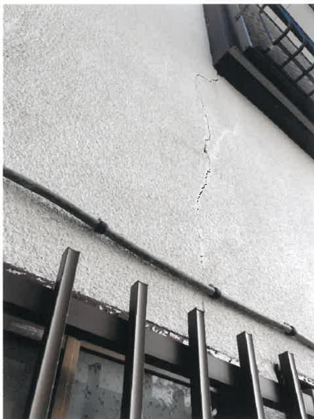
⑦同建物の外壁（１階と２階の間付近）のひび割れの状況
