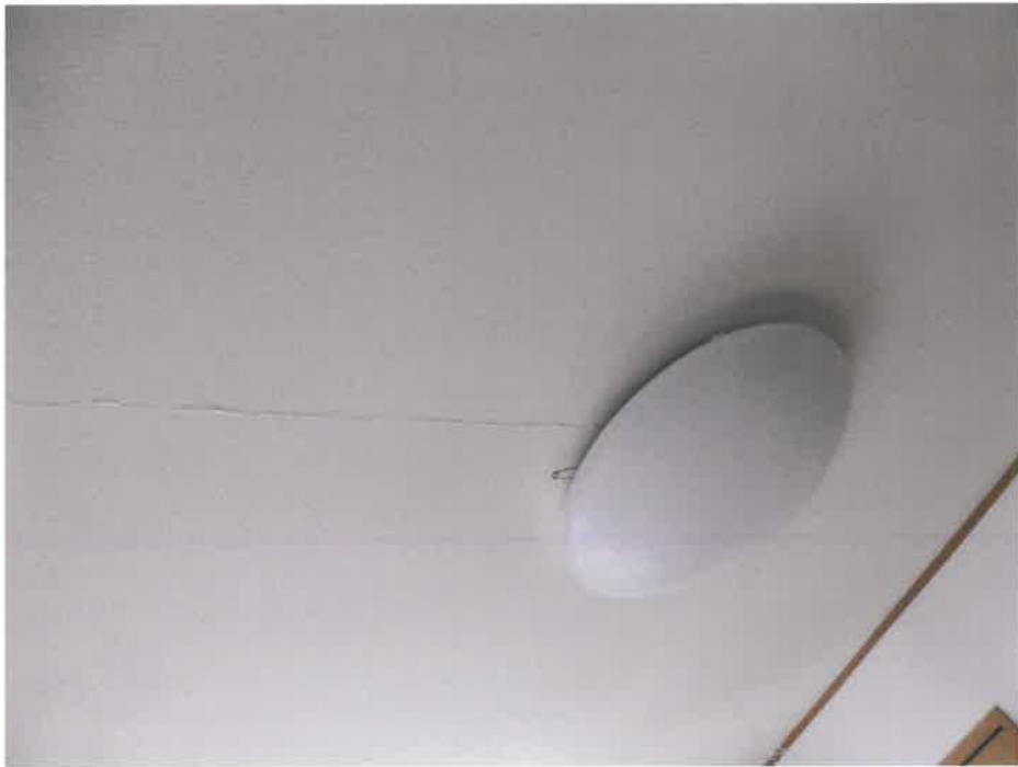
⑤ (天井クロスの亀裂の状況)
