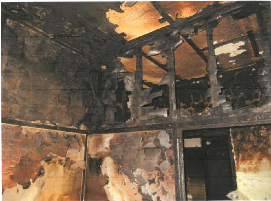
出火による損傷状況
