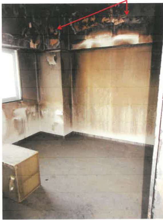
出火による損傷状況
