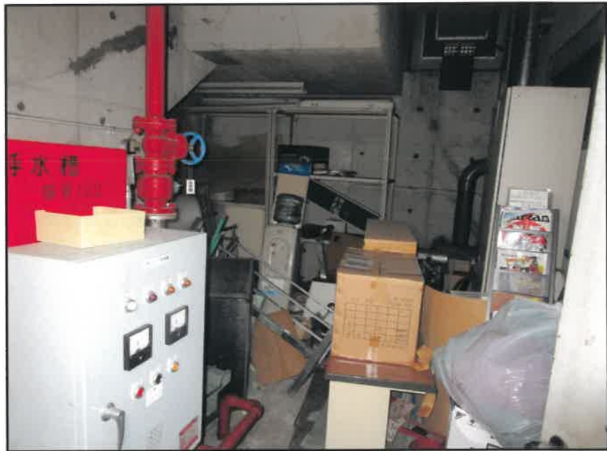
⑥ 建物内の状況－屋内消火栓ポンプ室(1階)
