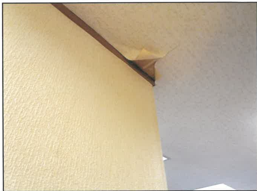
⑥ 建物内の状況—廊下天井部分の壁紙の剥がれ(雨漏りの影響)(2階)
