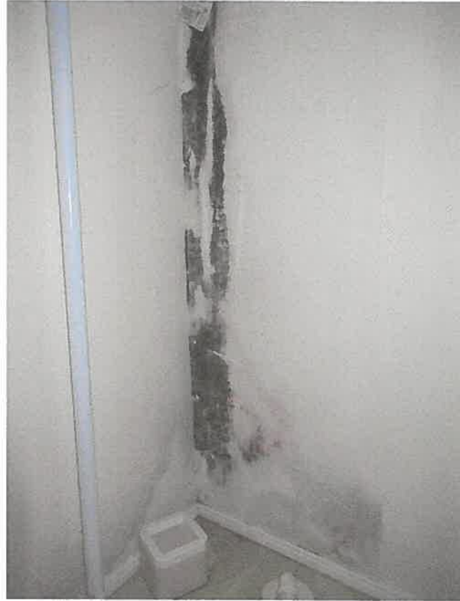
1階洗面所の洗濯機置場付近の内壁
